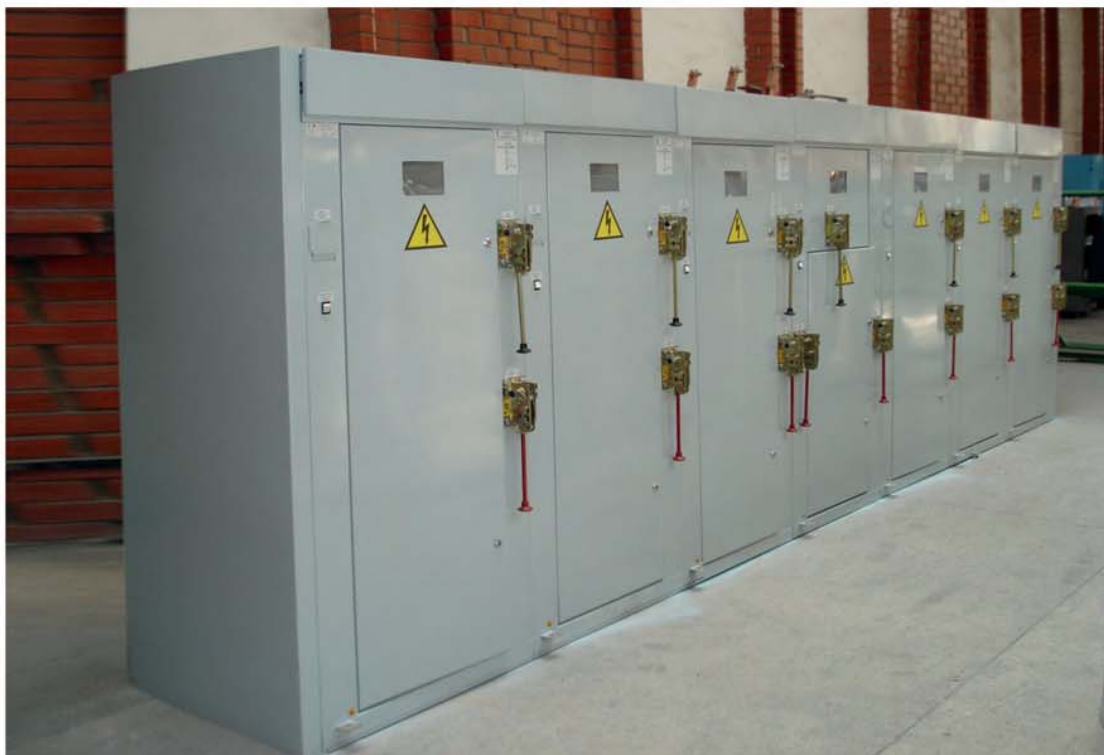
Рис. 2.2.6 Пример типового решения однорядного распределительного устройства из ячеек КСО 304 с выключателями нагрузки на вводах
